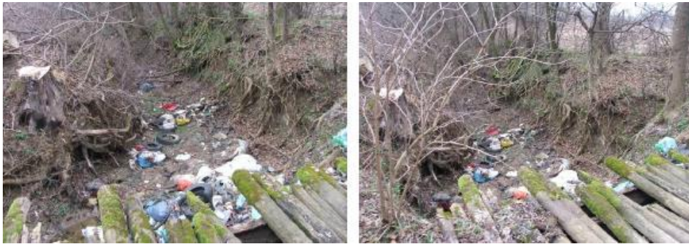
Слика 14. Приказ срушеног моста;
